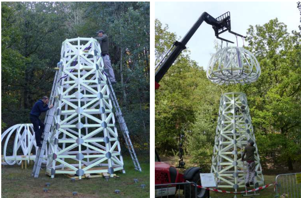
Préparation, levage et assemblage du «bulbe» sur la tour préalablement fixées au sol.
